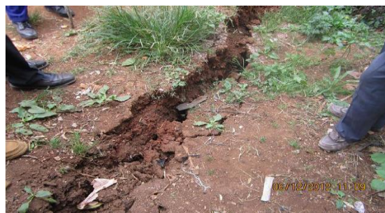
Cracks of the southern end of Landslide. Credit : Bureau des mines et de l'énergie (BME)
