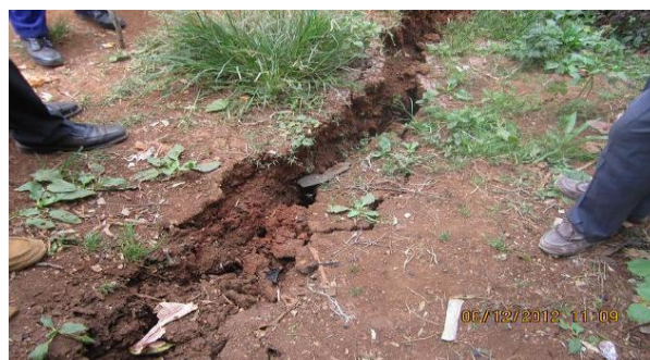
Photo I : Fissures observées au Sud de la tête du glissement. Crédit : Bureau des mines et de l'énergie (BME)
